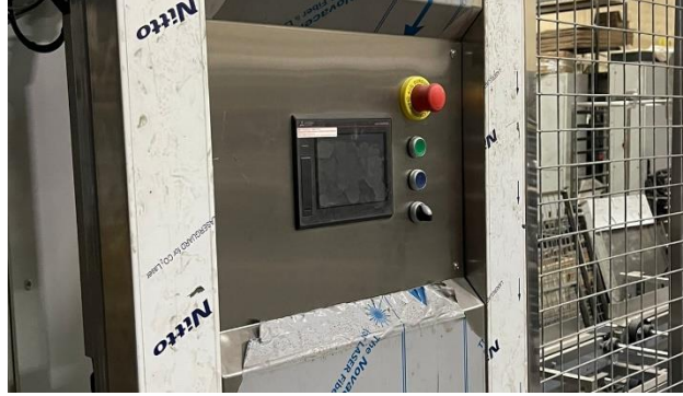
Şekil 3.10. PLC'nin Makine Panosu İçerisindeki Görüntüsü
