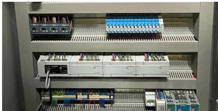
Şekil 3.9. PLC'nin Makine Panosu İçerisindeki Görüntüsü
